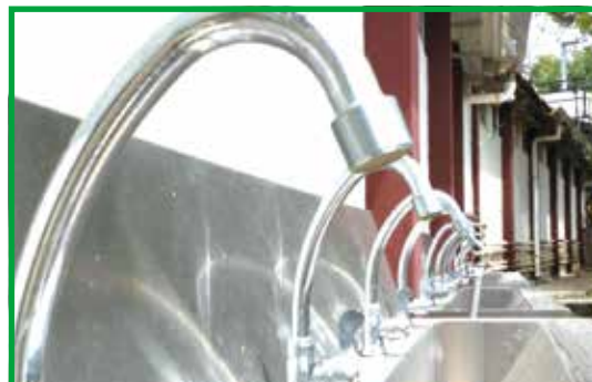
營內洗手設施。
